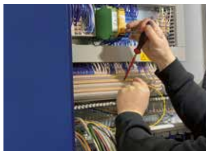
Einrichtung der elektronischen Steuerung
